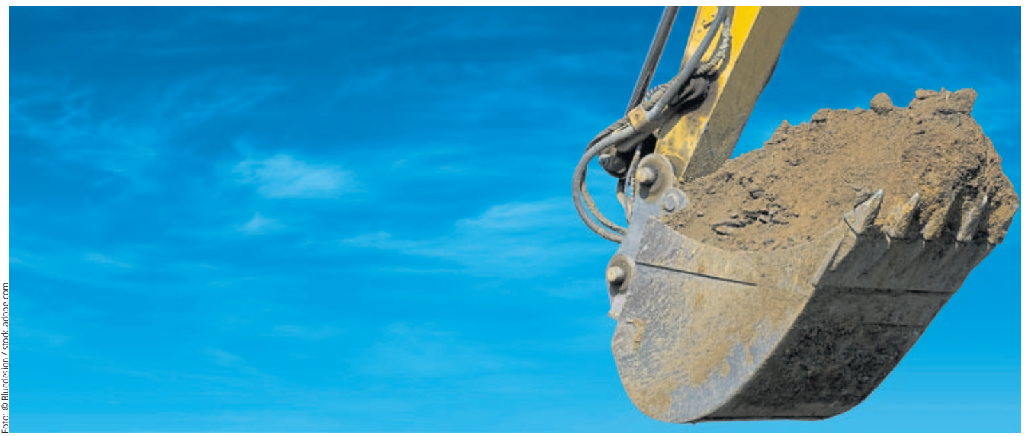
Einfacher Bodenaushub, nicht recycelbarer Bauschutt, stellt die Bauwirtschaft in der Region vor Herausforderungen und treibt den Preis für Bauherren nach oben.
